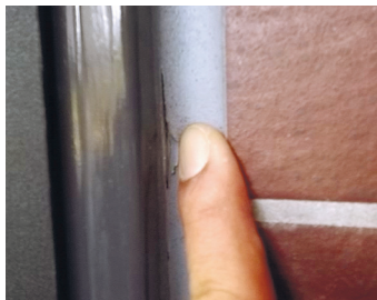
シーリングの破断 (写真1)
