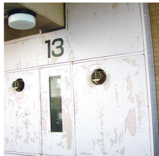
塩害に起因すると思われる塗膜の剥離・錆 (写真2)
