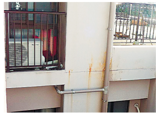
打継ぎ部にみられる錆汁の発生 (写真2)
