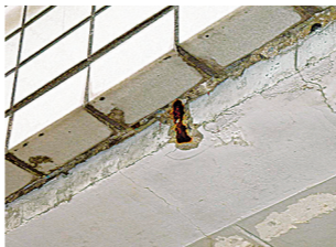
鼻先に発生した爆裂 (写真1)
